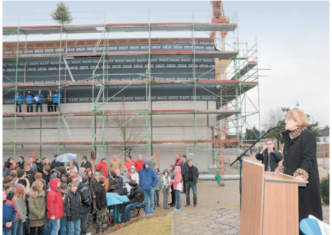
Unter Anteilnahme der Schüler, Lehrkräfte, Handwerker und Gäste wurde das Richtfest an der Dreifachturnhalle der Manchinger Realschule begangen.
