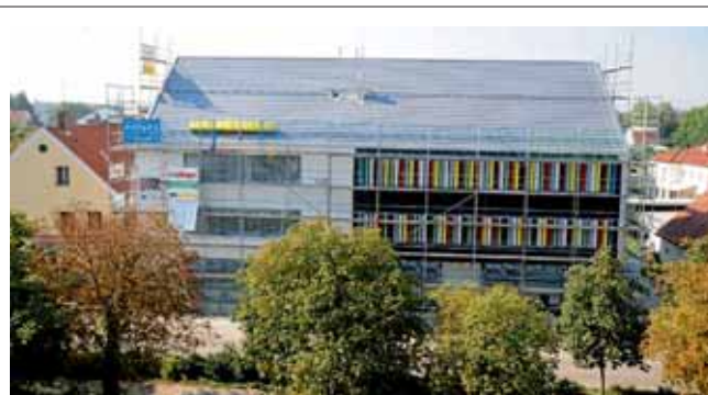
Die Arbeiten am Wärmeverbundsystem der gemeindlichen Bibliothek sind fast abgeschlossen. Mit den Fassadenplatten sowie den Estrich- und Trockenbauarbeiten wurde begonnen. Die Sonnenschutzanlage ist soweit montiert. Mit den Außenanlagen wird voraussichtlich in den nächsten Wochen begonnen.
